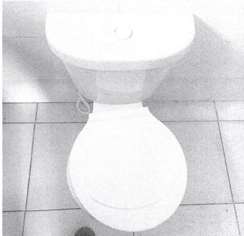
Foto 17- Vaso sanitario c/caixa de descarga acoplada
