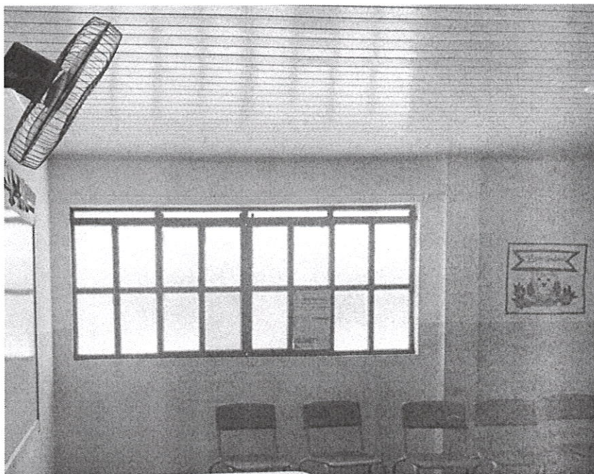
Foto 23- Revisão de Esquadria de madeira
